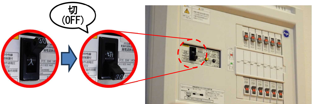
避難する際は分電盤のブレーカーを切る
